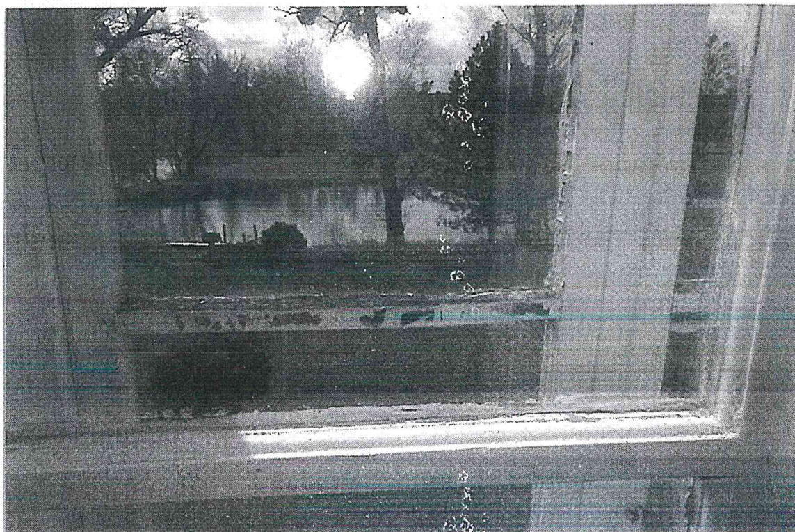
Fot. 26. Pałac w Tarnogórze k/ Izbicy z 1840 r. Stolarzka okienna i drzwi. Stan zachowania przed renowacją. Fragment okna od wewnątrz, ślimię zewnętrznego skrzydła zgnite. Marzec 2024 r. Fot. T. Sokal
