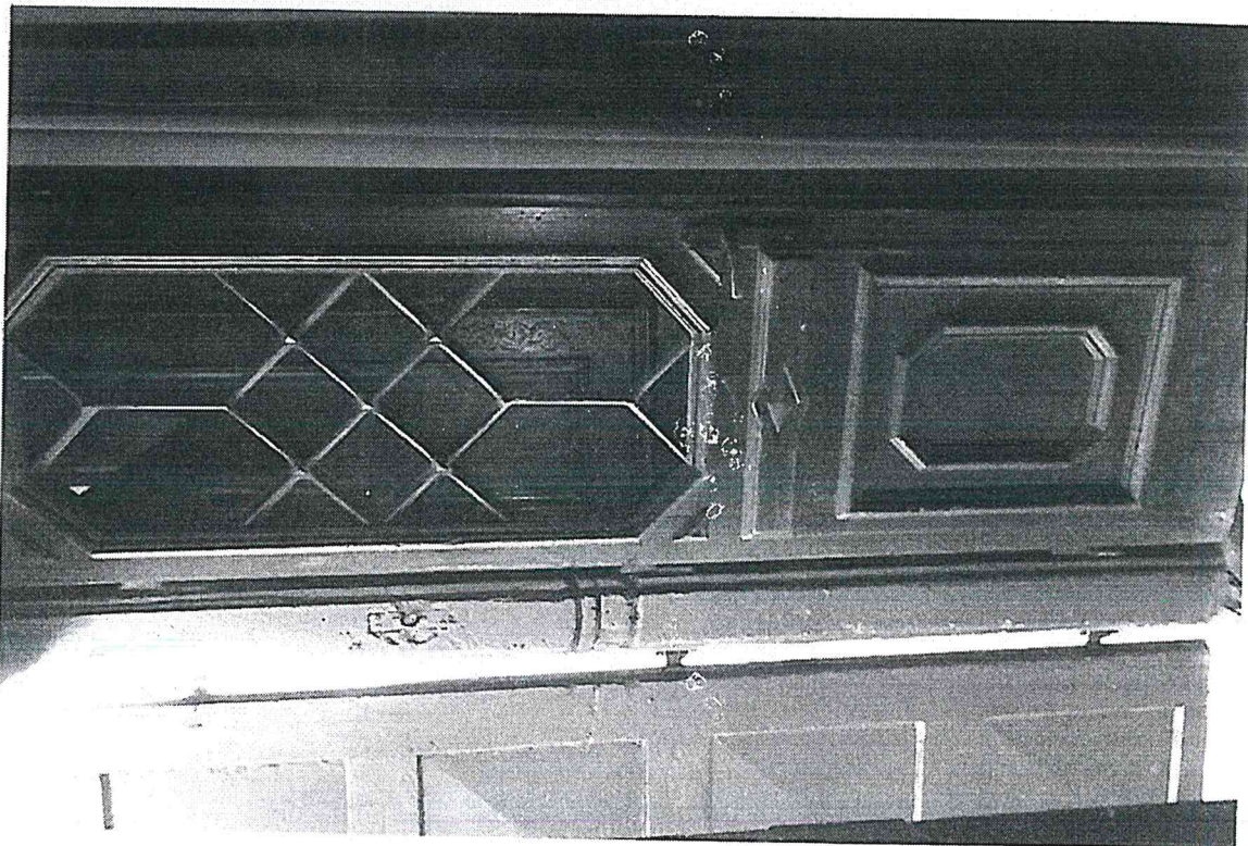
Fot. 6. Pałac w Tarnogórze k/ Izbicy z 1840 r. Stolarka okienna i drzwi. Stan zachowania przed renowacją. Wewnętrzne skrzydło drzwi wejściowych do palacu. W górnej części przeszklone geometrycznie. Widoczne przetarcia lakieru, klamka z szyldelem z końca 90-tych lat XX w. Grudzień 2023 r. Fot. T. Sokal
