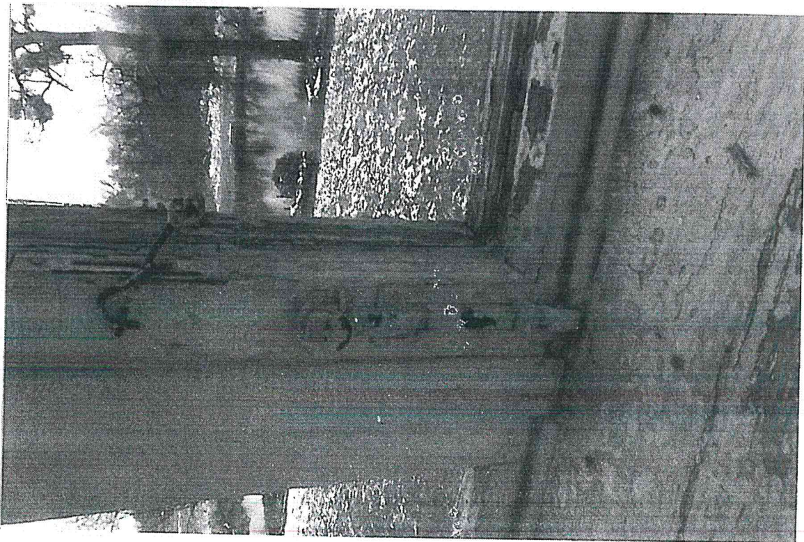
Fot. 22. Pałac w Tarnogórze k/ Izbicy z 1840 r. Stolarka okienna i drzwi. Stan zachowania przed renowacją. Fragment okna od środka z zasuwą, widok od wewnątrz. Grudzień 2023 r. Fot. T. Sokal
