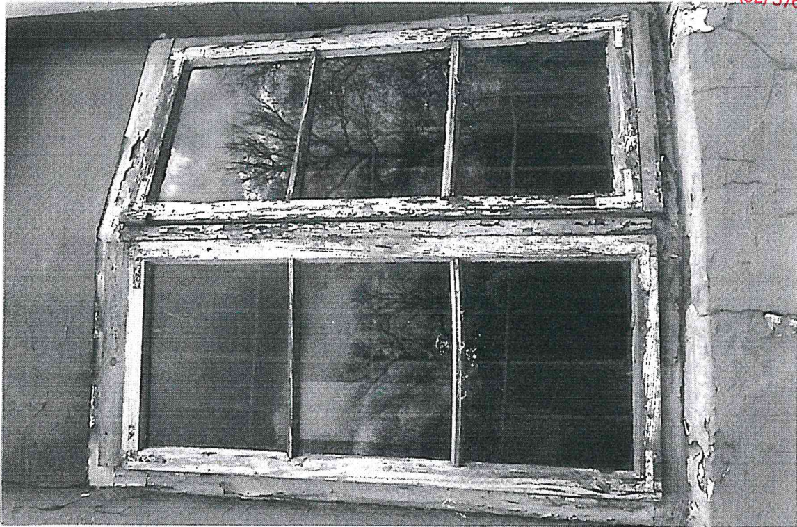
Fot. 13. Pałac w Tarnogórze k/ Izbicy z 1840 r. Stolarka okienna i drzwi. Stan zachowania przed renowacją. Okno w części parteru baszty, Warstwy farb olejnych złuszczone u dołu ramy zbutwiałe u dołu brakuje kitu. Grudzień 2023 r. Fot. T. Sokal
