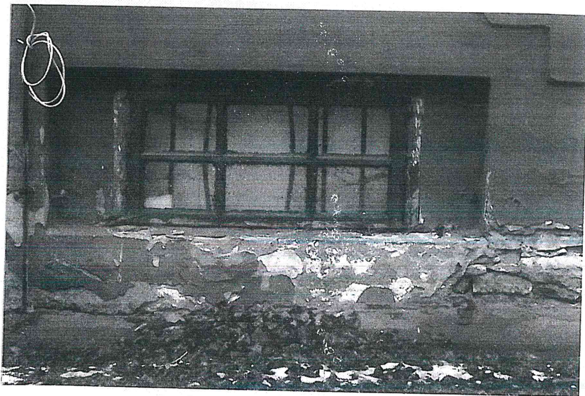
Fot. 20. Pałac w Tarnogórze k/ Izbicy z 1840 r. Stolarka okienna i drzwi. Stan zachowania przed renowacją. Okienko piwniczne od północnej elewacji po zachodniej stronie, Ościeżnica pierwotna stara, ramka przeszklona powojenna. Grudzień 2023 r. Fot. T. Sokal
