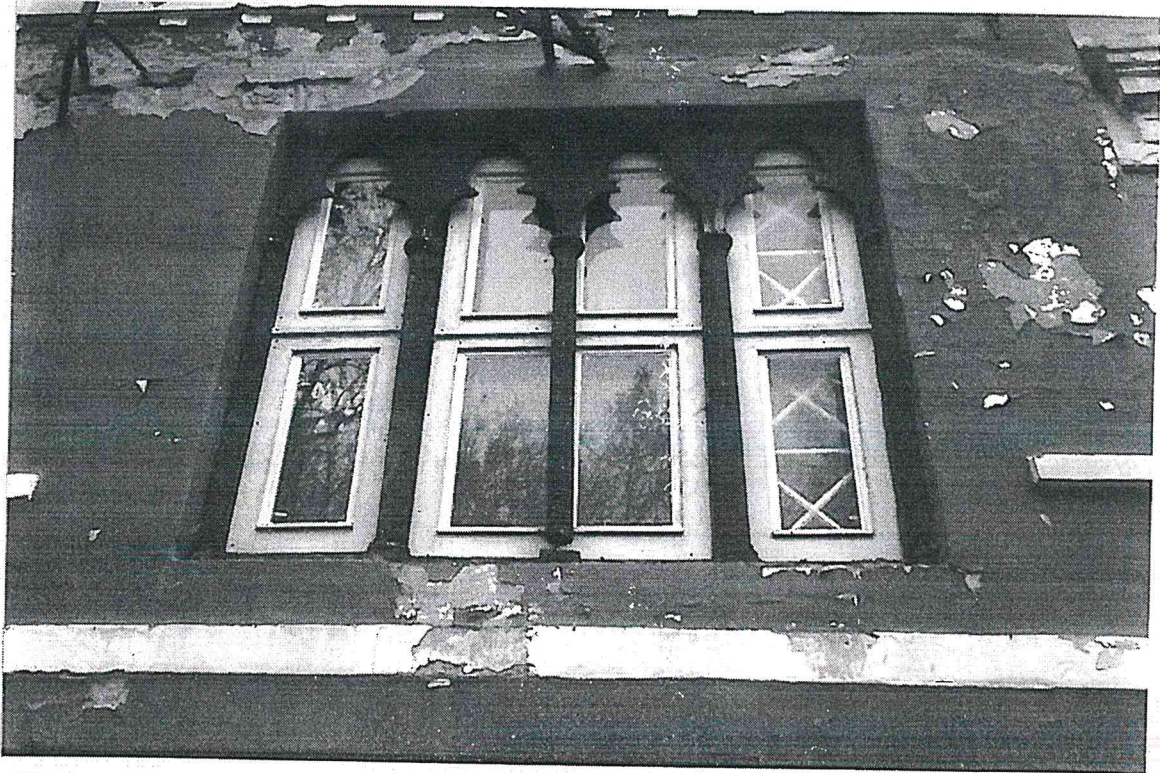
Fot. 12. Pałac w Tarnogórze k/ Izbicy z 1840 r. Stolarka okienna i drzwi. Stan zachowania przed renowacją. Elewacja zachodnia współczesne okno, na nim dekoracja neogotycka z pięciu smukłych kolumn. Grudzień 2023 r. Fot. T. Sokal
