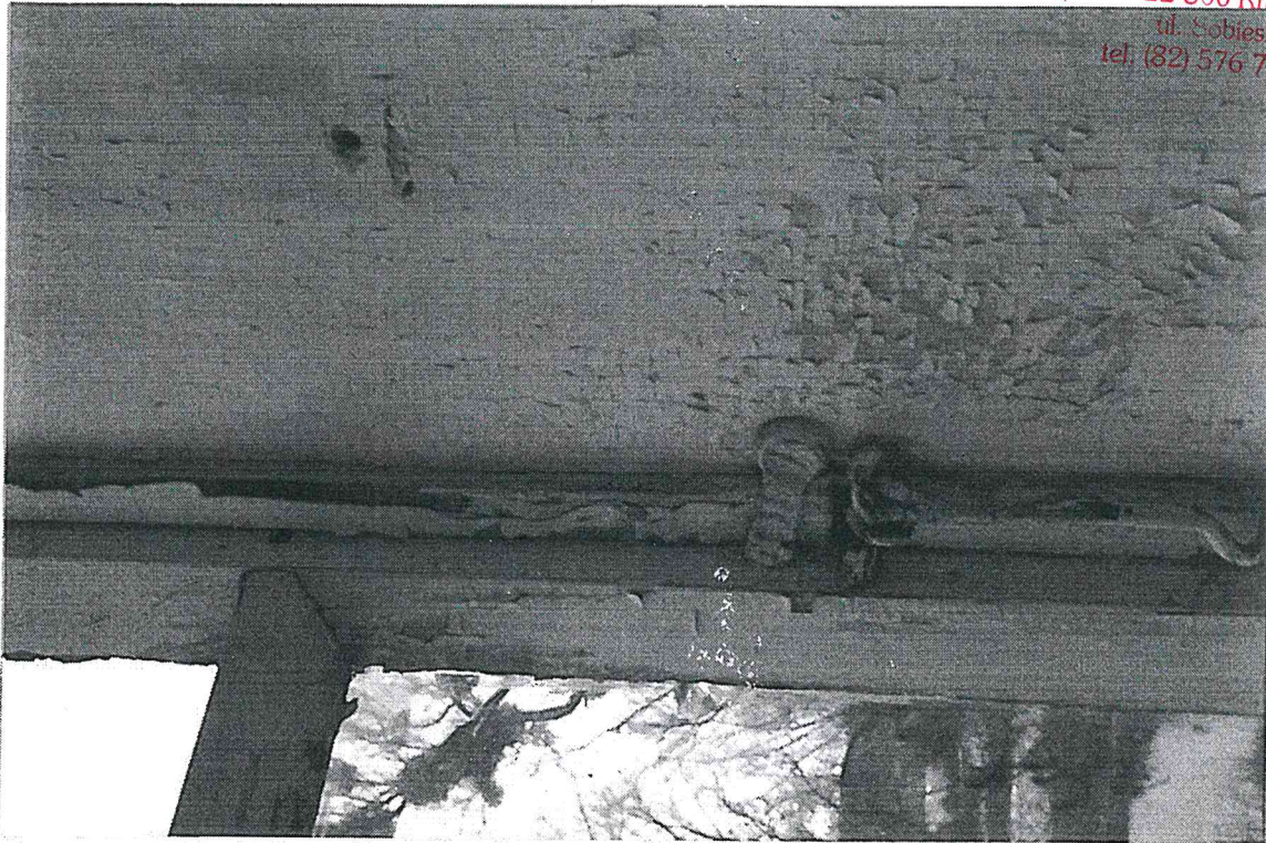
Fot. 21. Pałac w Tarnogórze k/ Izbicy z 1840 r. Stolarka okienna i drzwi. Stan zachowania przed renowacją. Fragment okna od środka z zaszczepką, widoczny najstarszy kolor stolarki okiennej jasno szaro-błękitny. Grudzień 2023 r. Fot. T. Sokal
