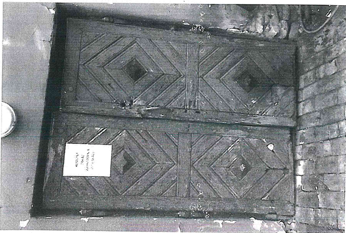
Fot. 10. Pałac w Tarnogórze k/ Izbicy z 1840 r. Stolarka okienna i drzwi. Stan zachowania przed renowacją. Elewacja zachodnia. Dwuskrzydłowe drzwi deskowe z opierzeniem klepkowym prowadzące do dolnej kondygnacji /piwnic/. Przemalowane, , prawe skrzydło opadnięte. Dolne części poszycia zbutwiały i częściowo zgnite. Grudzień 2023 r. Fot. T.S.
